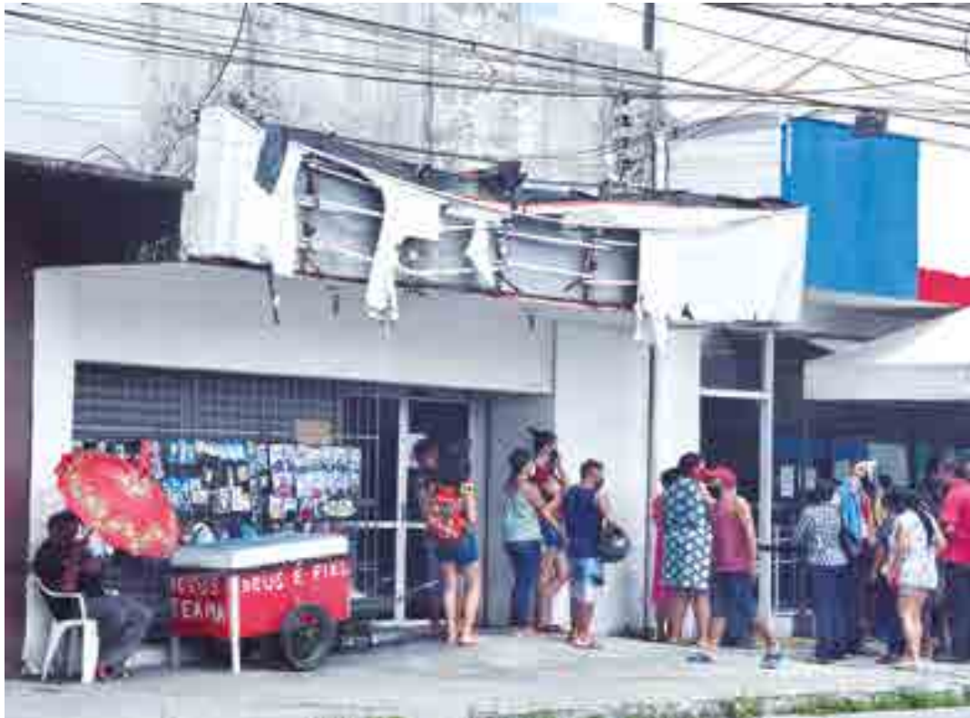
Placa de loja desativada na Avenida Cruz das Armas deteriorada pelo tempo pode desmoronar a qualquer momento
