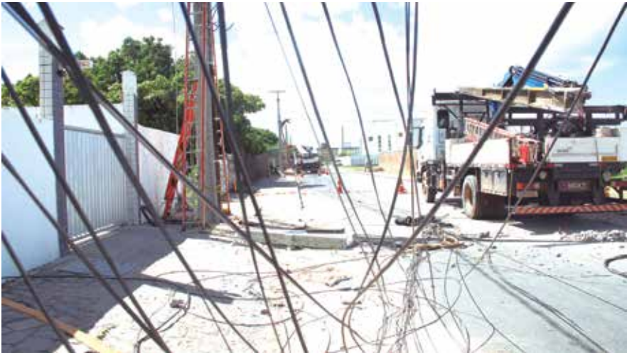
Abalroamento de postes exige cuidado das pessoas devido ao risco de choque elétrico
