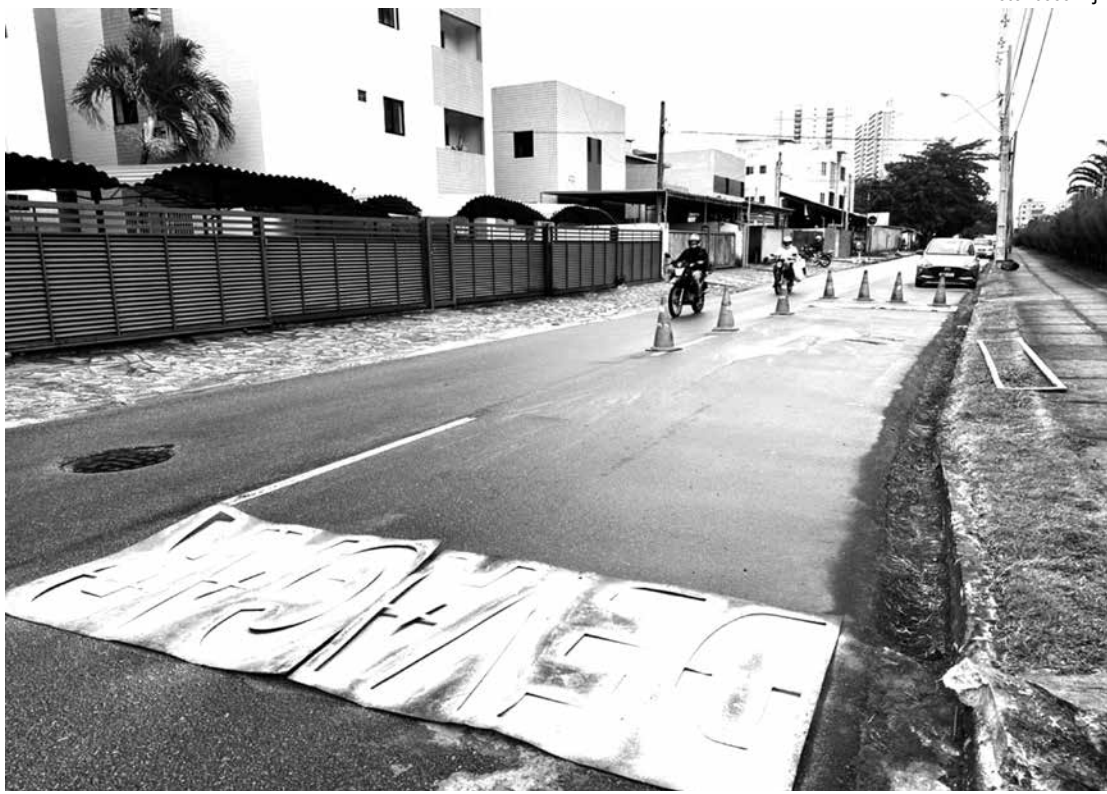
Sinalização horizontal na rua Estudante Manoel Soares de Lima já foi alterada pela Semob-JP
